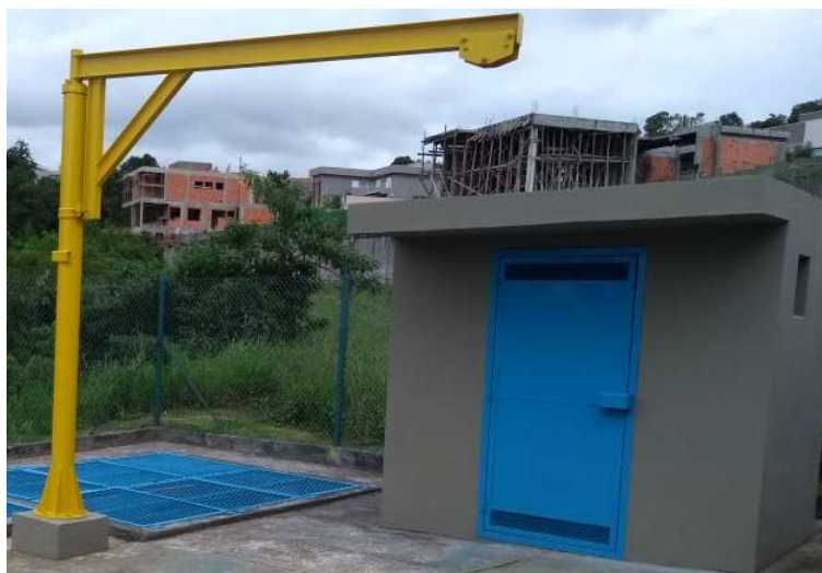
Fig.B16 – Estação Elevatória de Esgoto
