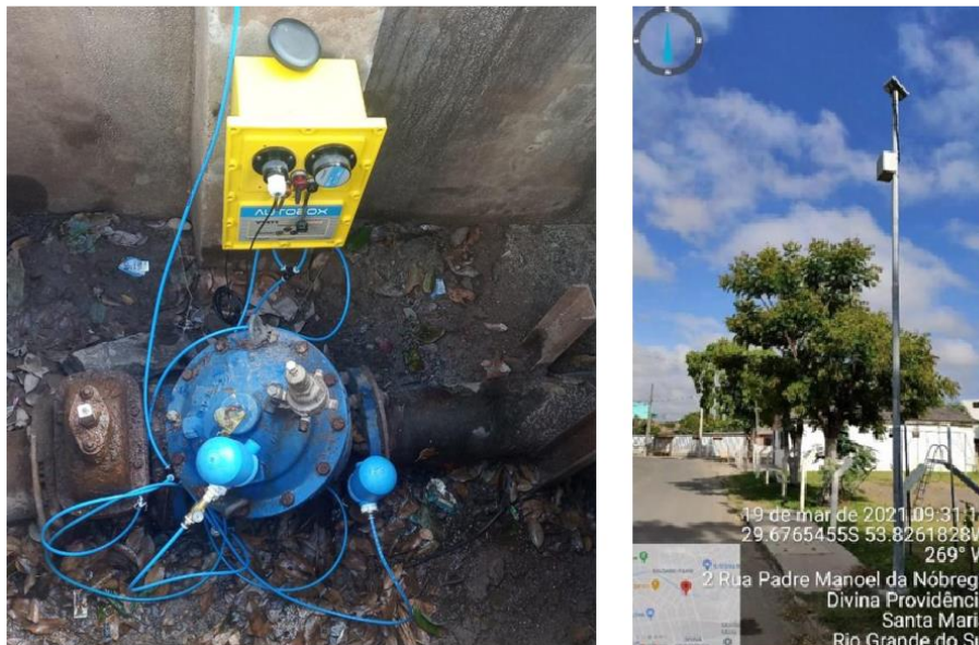
Figura 5 – equipamento AUTOBOX modulando VRP e placa solar para alimentação do sistema
